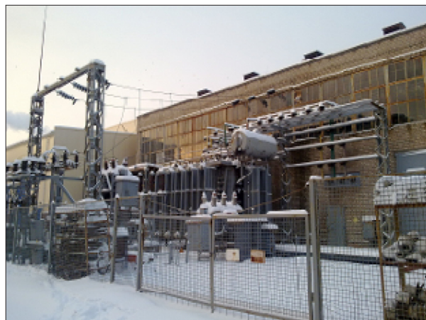
Подстанция, питающая испытательные стенды
