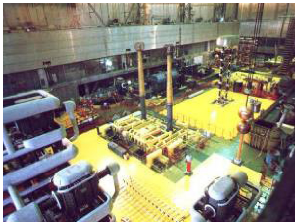
Большой высоковольтный зал
